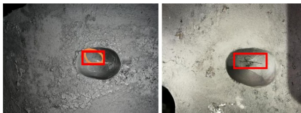
图13 焊缝打磨后缺陷照片
