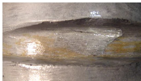
图17 焊缝打磨后缺陷照片
